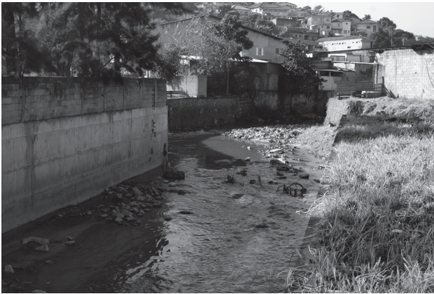
Figura 5. Trecho do Ribeirão Perus canalizado, com ocupação nas margens.
