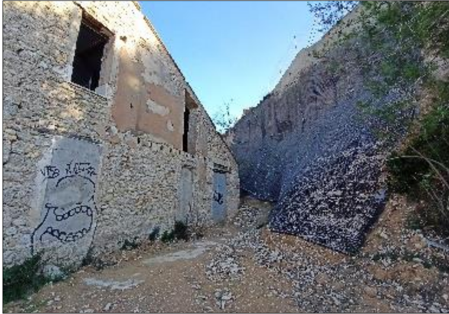
Imatge 12. Malla de protecció per a evitar el desprendiment de vessant darrere de la fàbrica d'Els Solers
