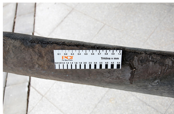
Obr. 2. Prasklina ve vrchní vrstvě laminátu Fig. 2. Crack in the laminate top layer
