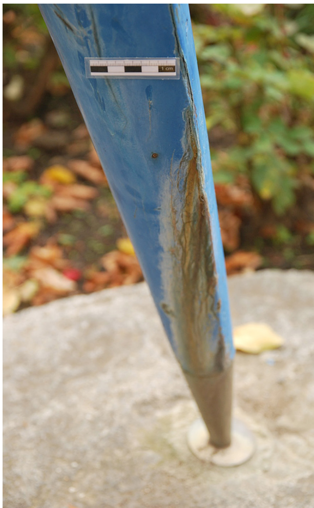
Obr. 12. Znečištění povrchu sochy korozními produkty železa
