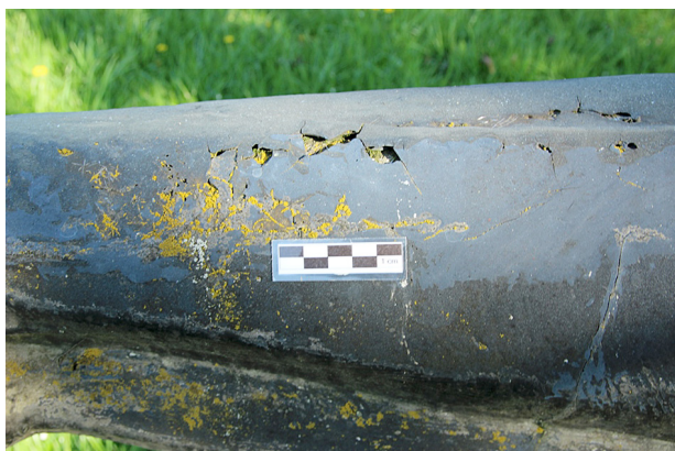
Obr. 7. Biologické znečištění v místech poškození vrchní vrstvy
