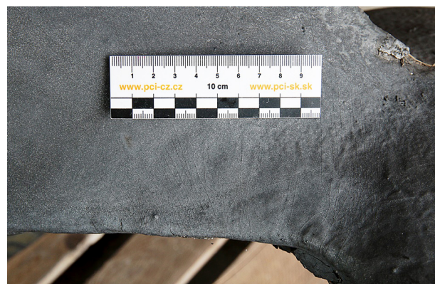
Obr. 1. Vlasové praskliny v povrchové vrstvě laminátu Fig. 1. Hairline cracks in the laminate surface
