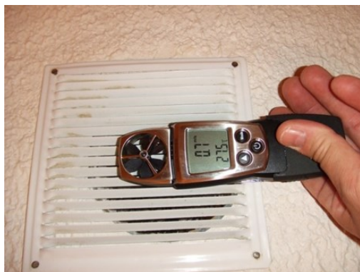
Fig.20. Detalle de anemómetro equipo usado en el interior en rejillas.
