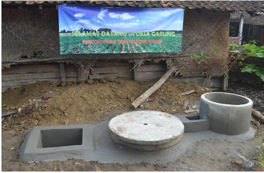
Gambar 4. Instalasi biogas (Dokumentasi Pribadi, 2015)
